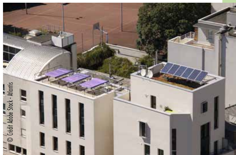
Panneaux photovoltaïques sur les toits à Paris
