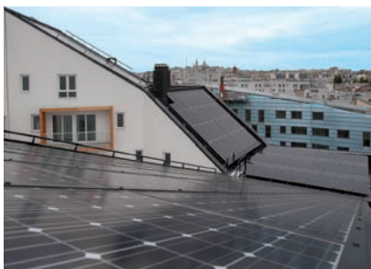
Panneaux photovoltaïques Zac Clichy Batignolles
