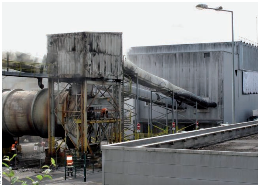
État de l'installation après l'incendie
